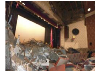
天井崩落(九段会館)【共同通信】
